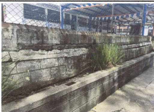
Foto 3: repello levantado por humedad.
