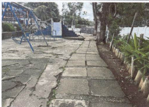
Foto 3: Desnivel de caminamiento por raíces
