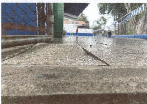
Foto 3: Debido a la humedad el piso se ha levantado
