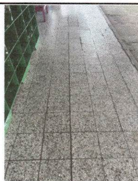
Foto 4: Se observa un abultamiento del piso debido a la humedad
