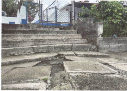
Foto1: Grietas en las gradas debido a raíces.
