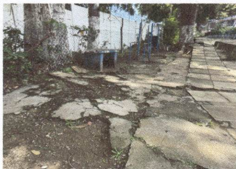
Foto 1: Levantamiento de torta y deterioro por lluvias y raíces.
