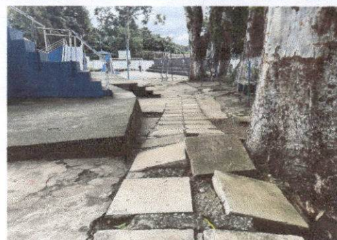
Foto 2: Levantamiento caminamiento por raíces de árboles.
