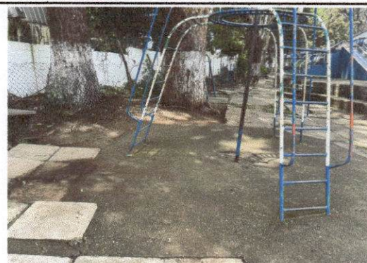
Foto 4: Deterioro de torta por raíces de árboles.
