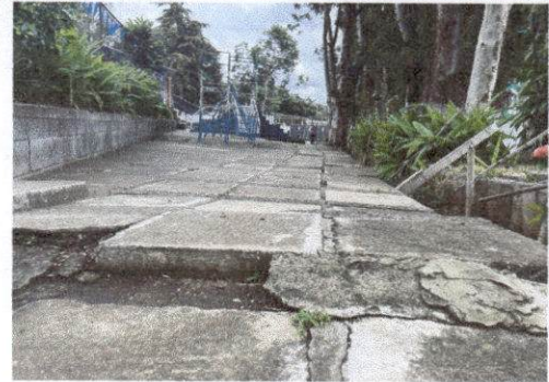
Foto 2: Deterioro en las planchas de concreto debido a raíces.
