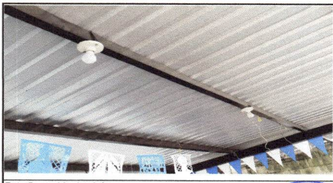
Foto 5: cambio de plafonera, por corto circuito.
