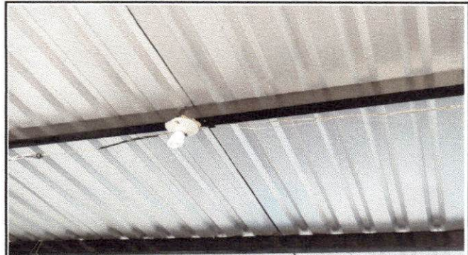
Foto 2: instalacion de luz en escenario, por corto circuito, no esta en funcionamiento.
