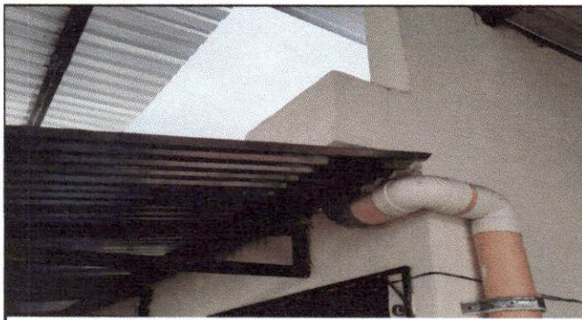
Foto 3: mantetnimiento a estructura portante, se encuentra tapado.
