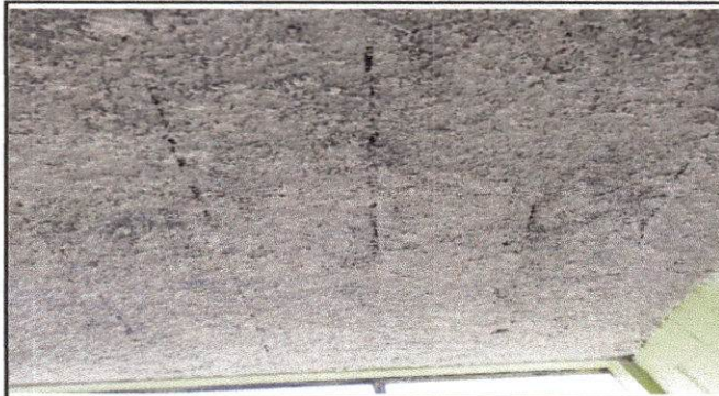
Foto 1: mantenimiento de techo, se esta desprendiendo el repello del techo, debido a que ya es muy antiguo.
