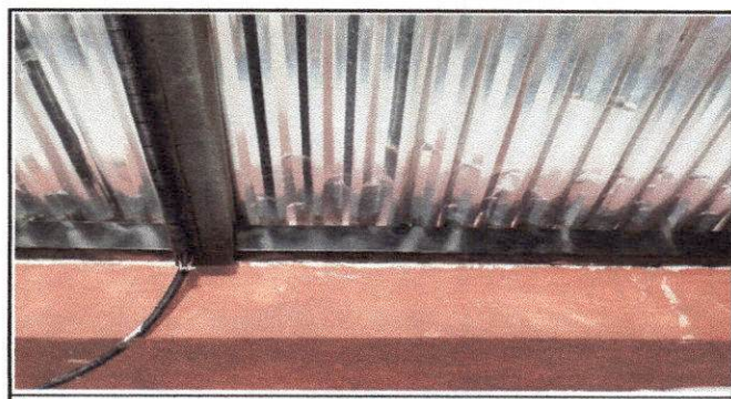
Foto 6: cambio de lamina en el area de la cocina, tiene filtraciones de agua.
