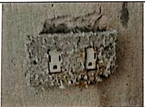
Foto 5: Suministro de toma corrientes en los cubículos.
