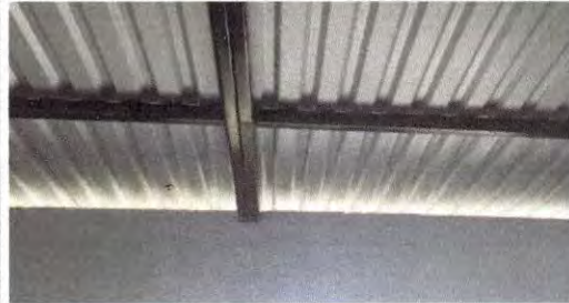
Reparación de muro en los salones de parvulos 3 por filtración de humedad y es entrada de animales que dañan el material y mobiliario. animales como gatos, ratones y murciélagos
