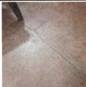
Colocación de piso de cocina por agrietamineto
