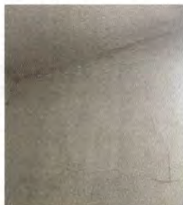
Repello y cernido de paredes interiores No.4 en la Bodega por agrietamineto debido a la humedad
