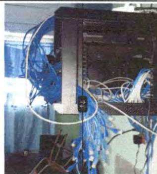
Foto 2: rack y switch en mal estado
