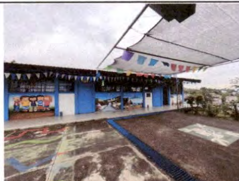
Foto 4: Canal con bajadas pluvial en techo de patio, Módulos B
