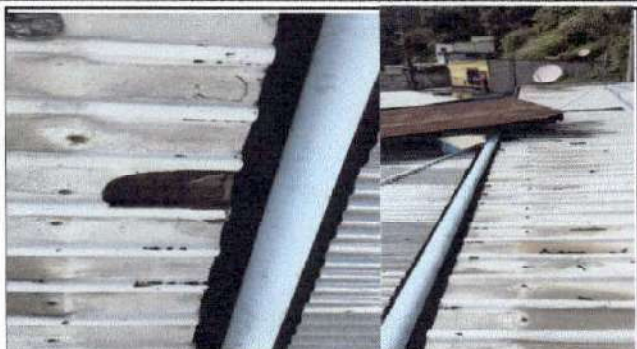
Foto 1: en la cubierta hay filtración de agua por gotera, así mismo se encuentra oxidado.
