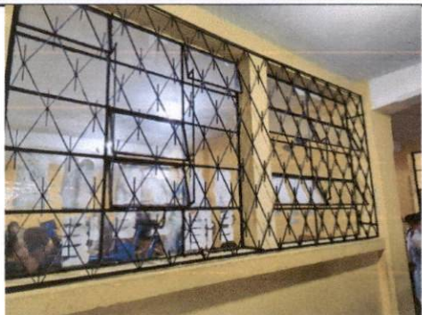
Foto 1: Ventanas hechas de metal, impiden la ventilación dentro del salón de clases.
