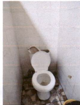
Foto 4: Los sanitarios actuales son de uso doméstico, sufren daños significativos con el tiempo, debiendo reparar constantemente.
