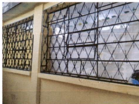
Foto 2: En época de calor, los salones no tienen suficiente ventilación
