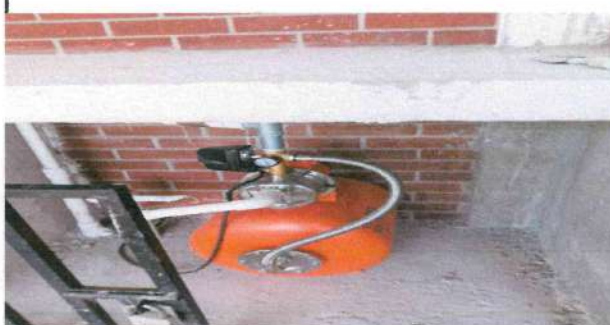
Foto 6: BOMBA DE AGUA
