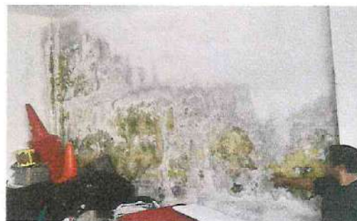
Foto 4: humedad de las paredes impermeabilización
