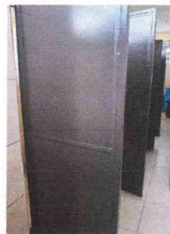
Foto 6: Puertas Servicios Sanitarios Niños
