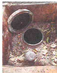
Foto 2: tinaco a cambiar por daños.
