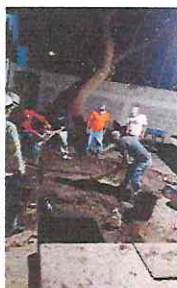
Foto 3: momento donde colapso el tinaco de aguas negras.
