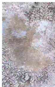
Foto 1: parte dañada donde se realizó el proyecto.
