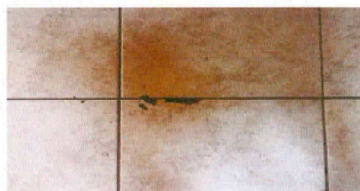
Foto 10: Sustitución de seis pisos cerámicos, en el segundo nivel dos, y cuatro en el primer nivel, pisos que se encuentran quebrados en dos aulas.
