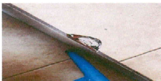
Foto 9: Sustitución de seis pisos cerámicos, en el segundo nivel dos, y cuatro en el primer nivel, pisos que se encuentran quebrados en dos aulas.
