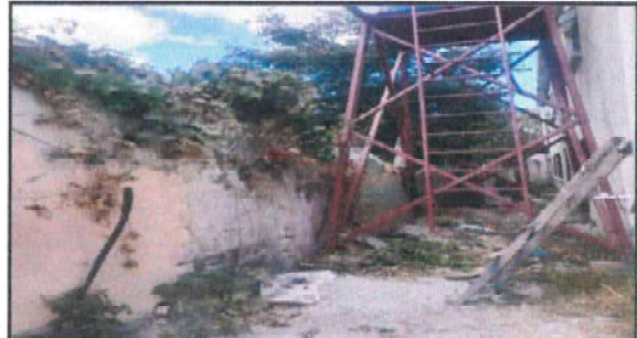
FOTO 2: Muro destruido y desnivelado en el perímetro poniente junto a módulo de preparatoria.
