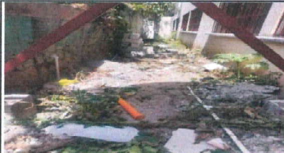
FOTO 1: Muro destruido y desnivelado en el perímetro poniente junto a módulo de preparatoria.
