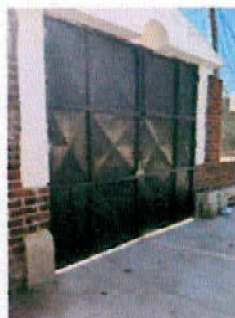
Foto 8: En esta foto se evidencia el porton de la escuela que se le realizará un remozamiento de pintura.
