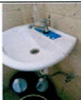
Foto 11: Foto que muestra la necesidad de arreglar los lavamanos de los sanitarios de la primaria. 4 lavamos para arreglar
