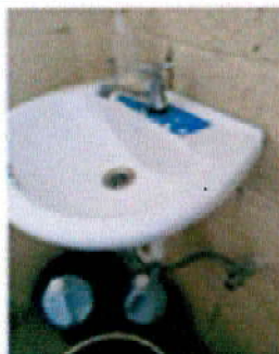
Foto 9: Foto que muestra la necesidad de arreglar los lavamanos de los sanitarios de la primaria. 4 lavamos para arreglar
