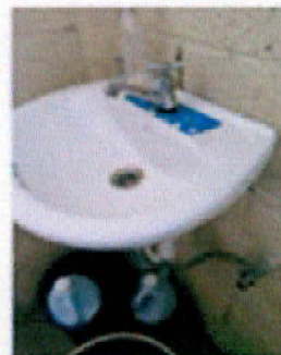
Foto 10: Foto que muestra la necesidad de arreglar los lavamanos de los sanitarios de la primaria. 4 lavamos para arreglar
