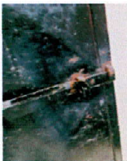
Foto 7: Foto que evidencia la necesidad de arreglar los pasadores de las puertas de los sanitarios
