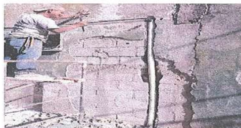
Foto 2: sellado en fisuras de pared
