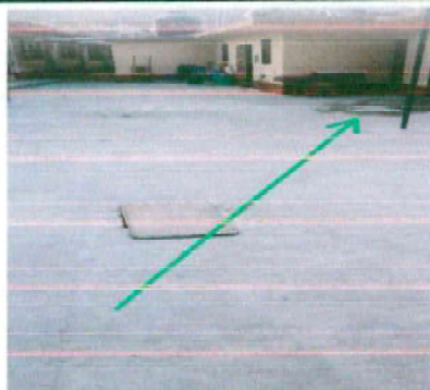
Foto 3: Sustrucción de drenaje y agua pluvial
