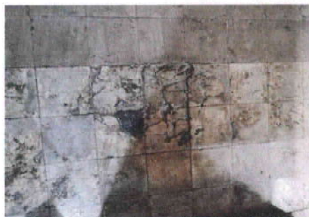
Foto 3: Secciones con piso quebrado
