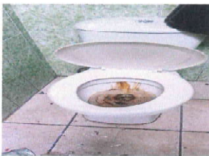
Foto 5: Baños tapados y con fugas de agua
