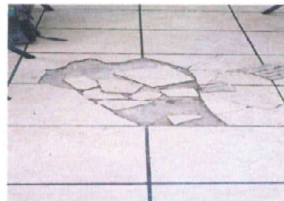
Foto 4: El piso cerámico se ha ido quebrando con el transcurrir el tiempo
