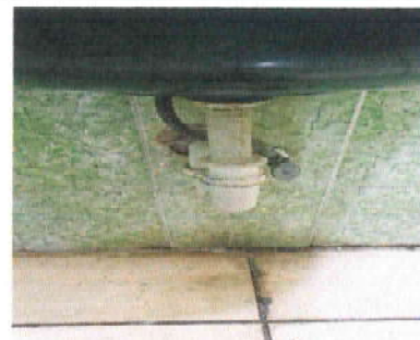
Foto 6: tubería de los lavamos tienen fuga
