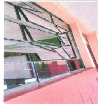
Foto 2: Los vidrios de algunas ventanadas están rotos
