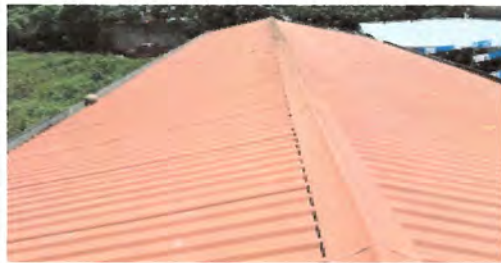
Foto 9: SUSTITUCION DE CAPOTE
