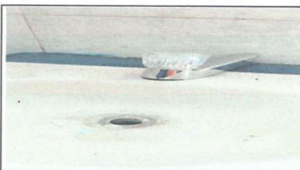
Foto 8: Sustrucción de mezcladora lavamanos (contra llave, tubo de abasto)
