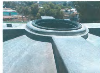
Foto 12: Sustrución de accesorios deposito de agua (tapaderas de tinacos)
