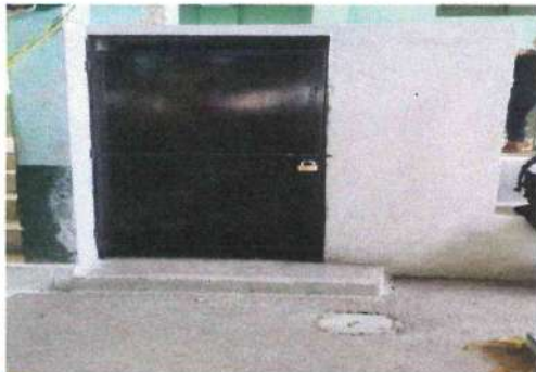
Foto1: CASETA PARA BOMBA E HIDRONEUMATICO
