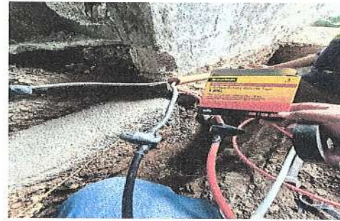
Foto 2: INSTALACION PARA BOMBA DE AGUA E HIDRONEUMATICO
