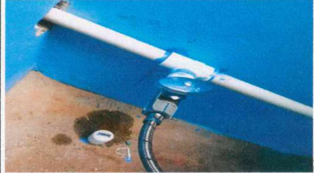
Foto 8: Sustrucción de tubería de agua potable línea principal, mejoramiento de uso de los sanitarios
