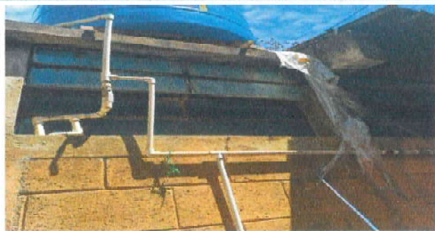
Foto 1: Tubería de agua potable con problemas de instalación por antigüedad
