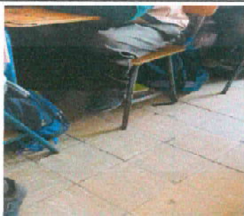
Foto 1 piso en aulas de cuarto a, b, quinto a, b
