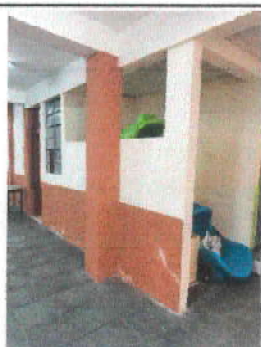
Foto 5: Presencia de humedad en primer nivel.
