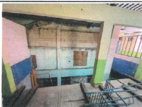
Foto 3: Paredes en mal estado.
