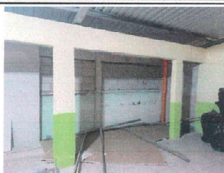
Foto 2: Paredes de tabla yeso en mal estado.
