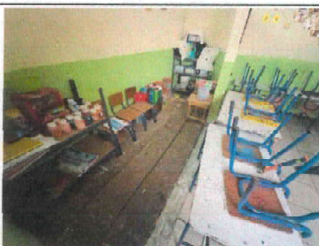
Foto 4: Tableros rústicos mal instalados
