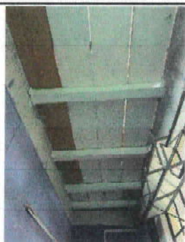
Foto 1: Estructura metálica con tableros mal instalados.
