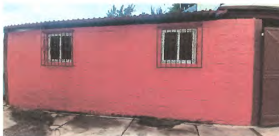
Foto 4: MUROS DE COCINA SIN REPELLO EXTERIOR
