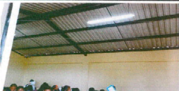
FOTO #03: NECESIDAD IMPLEMENTACION DE CIELO FALSO
