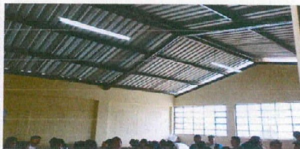
FOTO #04: NECESIDAD IMPLEMENTACION DE CIELO FALSO
