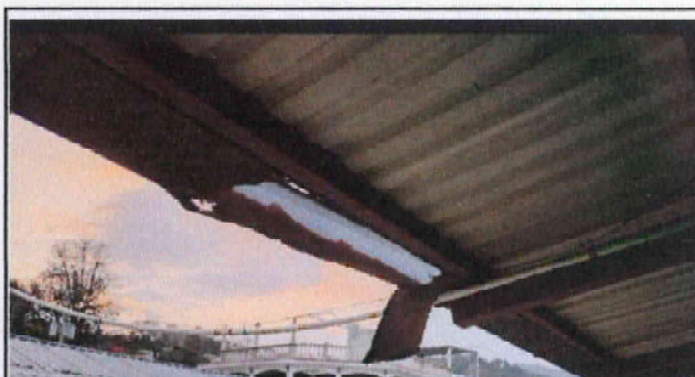
Foto 4: Sustitución de los canales del área externa del establecimiento, siendo que todos se encuentran en mal estado.
