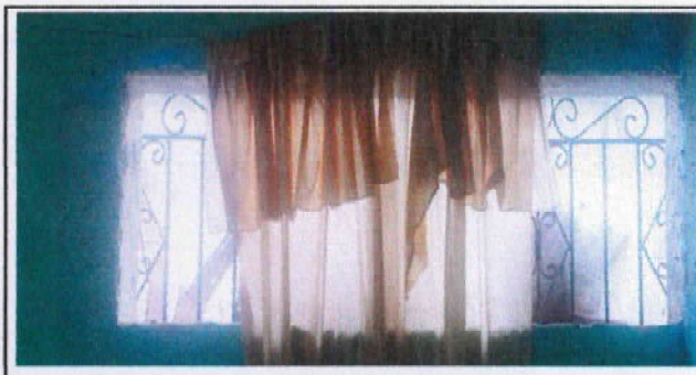
Foto 6: Esta es la segunda ventana a sustituir, la cual se encuentra en las mismas condiciones que la de la foto 5
