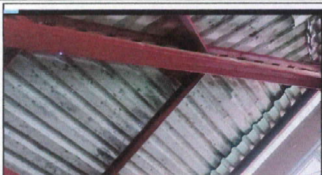
Foto 1: Sustitución de 60 láminas que están en mal estado, lo cual permite la caída de agua en diferentes espacios del establecimiento.
