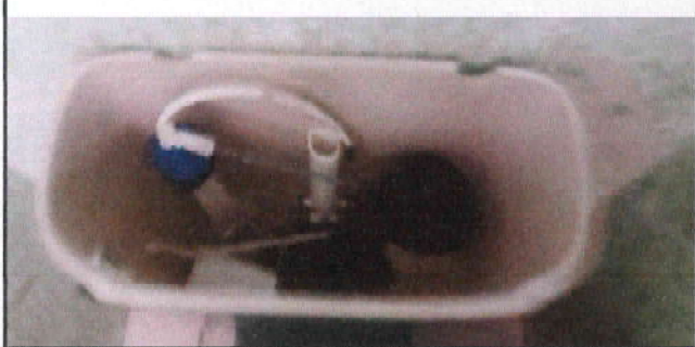
Foto 7: Reparación total de 4 tanques de los sanitarios de las mujeres y 2 de los hombres porque no funcionan sus accesorios, por lo que la aplicación del agua es manual y 6 tapaderas plasticas para las tazas
