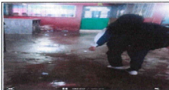
Foto 3: Sustitución de canales, ya que todos están en mal estado, esta es la situación real adentro del establecimiento en periodos de lluvia.
