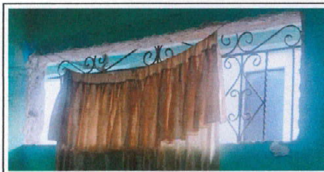
Foto 5: Sustitución de 2 ventanas de 1 aula donde solo existen balcones y sedazo que los padres de familia han colocado para evitar que las personas lanzen objetos desde afuera.
