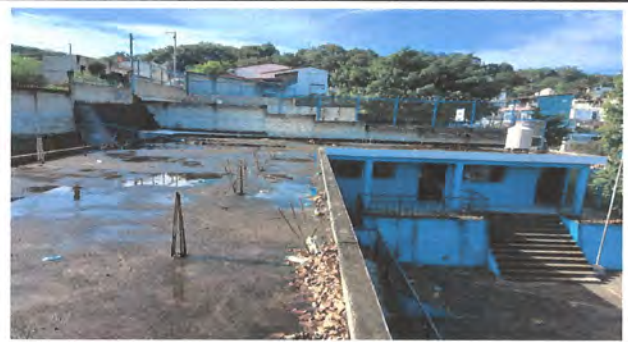
Foto 4: foto de techo parte en forma de L, la cual muestra la retención de agua, por la falta de limpieza en las caídas de agua, las cuales son internas
