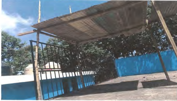
Foto 1: cambio de techo en el area del patio para realizar educacion fisica, actividades, y periodo de recreo. Se necesita cambio de este techo por uno mas formal.
