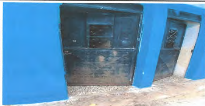
Foto7: puerta de frente del baño femenino la cual la chapa no sirve, y la parte de abajo esta picada por el agua.
