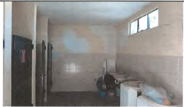
Foto 6: foto de los sanitarios femeninos en donde se debe realizar cambios tanto en sanitarios como en los lavamanos e inodoros y paredes.
