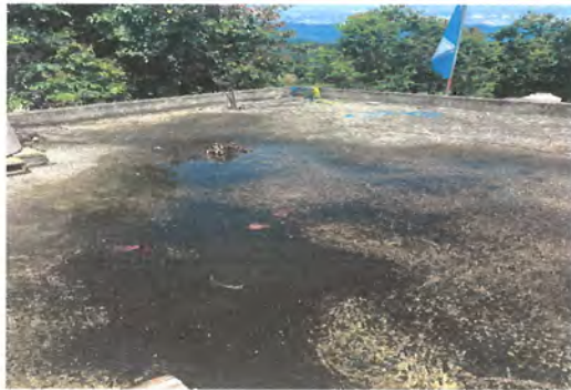
Foto 5: foto de parte frontal del edificio la cual esta en condiciones de retencion de agua, y las ciadas de agua llenas de hojas y asi mismo se nota el desgaste de la terraza ya que se le ha hecho reparación
