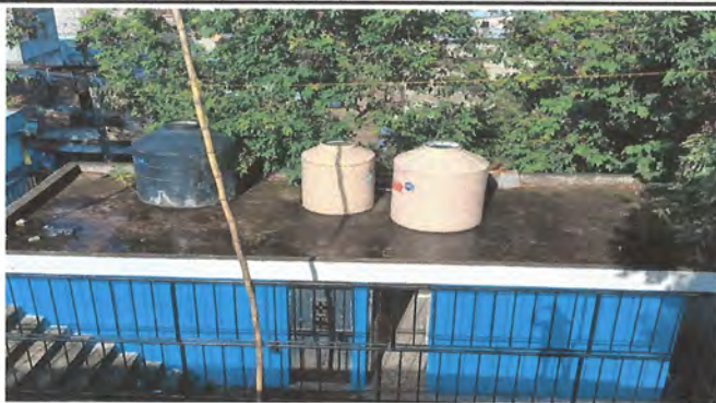
Foto 3: techo de los sanitarios tambien tiende a tener retenida el agua llovediza, ya que las caidas tienen basura y hojas de los arboles.
