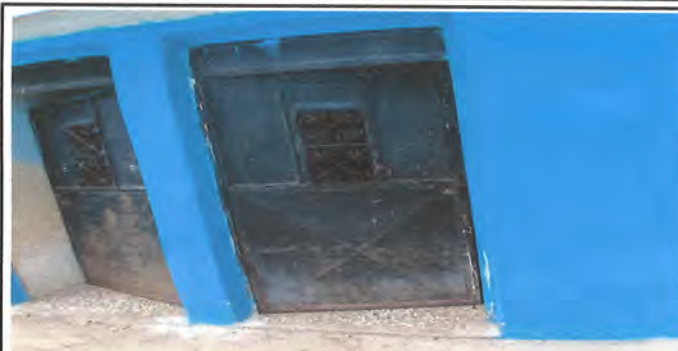
Foto 8: puerta del baño masculino el cual esta en las mismas condiciones que el anterior, chapa no funciona y esta desnivelada.
