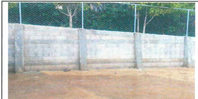
Foto 6: Muestra muro que necesita pintura.
