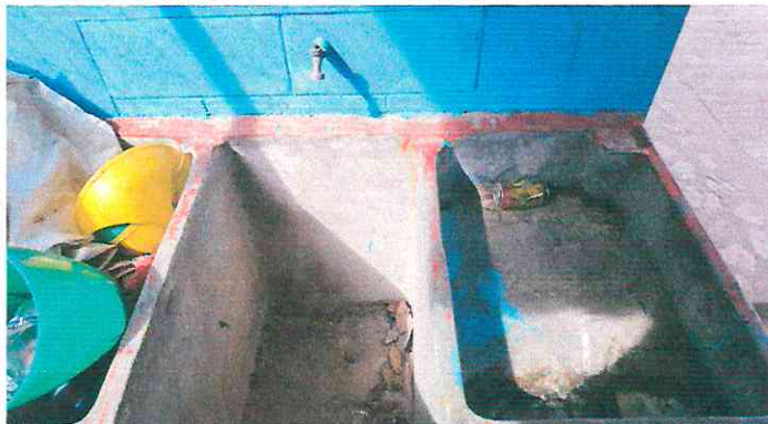
Foto 8: Sustrucción de pila en area de patio, con su drenaje de aguas negras y agua potable correspondiente.
