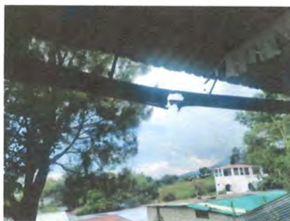
Foto 3: 7. Sustrucción de canal de metal para agua pluvial
