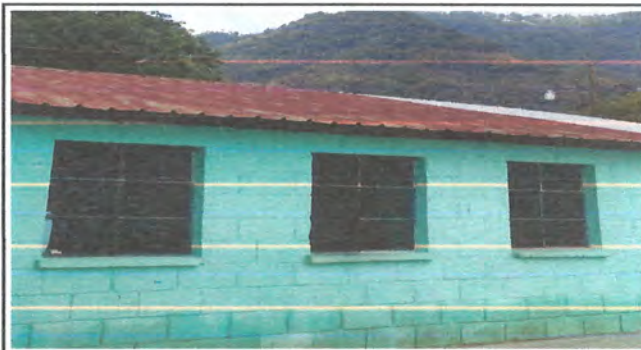
Foto 10: se tiene previsto cambio de lámina por lámina troquelada de aluzinc calibre 26 y mantenimiento de estructura de techo en aula de párvulos
