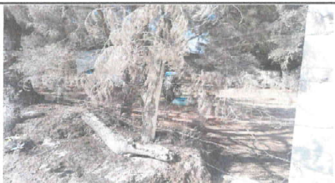
Foto 3: UNICAMENTE SE VE EL ALAMBRE QUE EN SE COLOCO EN LUGAR DE LA MALLA Y SU ESTRUCTURA. URGE VOLVER A COLOCAR SU MALLA CON SU TUBO GALVANIZADO.
