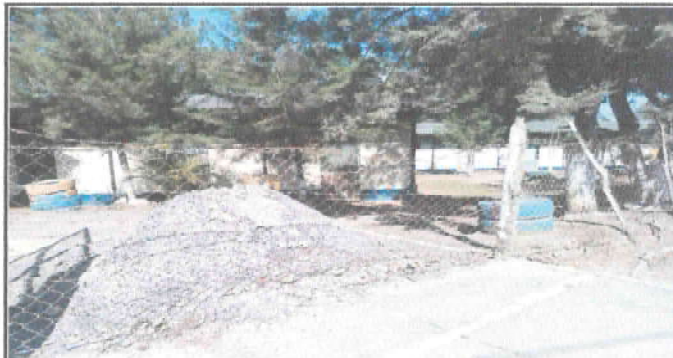
Foto 2: SE PUEDE OBSERVAR QUE LA MALLA ESTA DETERIORADA, POR LO QUE ES NECESARIO SUSTITUCIÓN DE MALLA Y REFORZAR CON TUBO GALVANIZADO.
