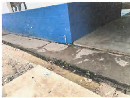
Foto 4: Sustrucción de torta de concreto
