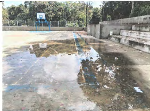
Foto 2: Sustrucción de tubo PVC de 4" de drenaje de cancha deportiva (incluye demolición y reposición de concreto), también se hará sustitución de reposadera
