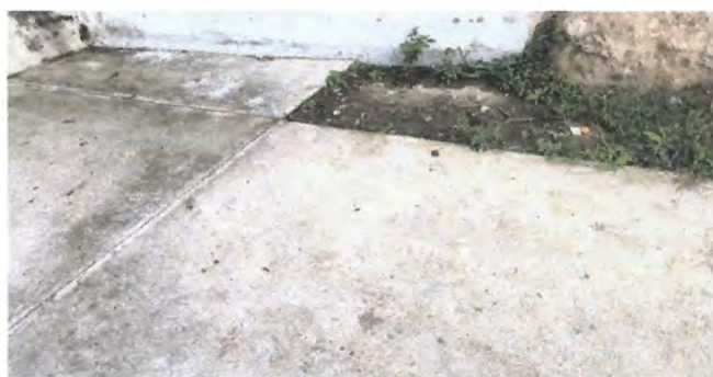
Foto 3: Sustrucción de torta de concreto
