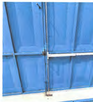
Foto 2: mantenimiento de portones en malas condiciones
