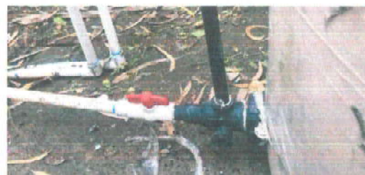
Foto 2: ACCESORIOS DEL DEPOSITO DE AGUA.
