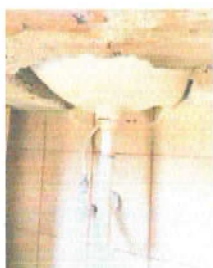
FOTO 9: LAVAMOS CON FUGA LOS CUALES SE CAMBIARAN.
