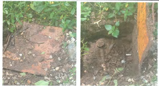
Foto 16: Sustrucción de caja de contador.
