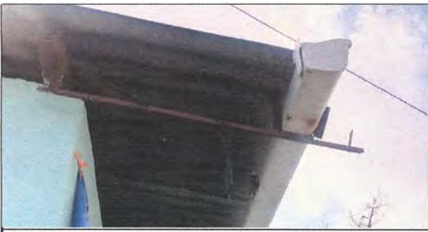
Foto 11. Sustrucción de soporte o pescante para canal
