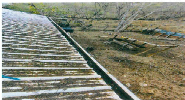
Foto 1: según Region 4.3 Sustitución canal pvc (incluye bajadas de agua)
