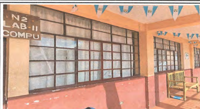
Foto 2: Necesidad de colocar balcones en el laboratorio de computación del 2do. Nivel, para resguardo del equipo de computo.
