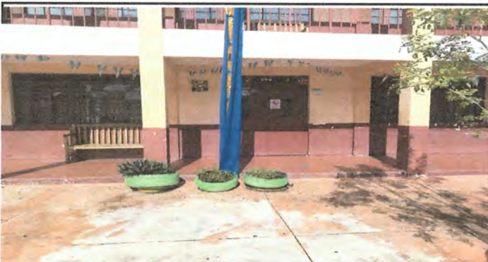
Foto 3: Necesidad de colocar balcones en el laboratorio de computación del 1er. Nivel, para resguardo del equipo de computo.
