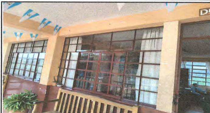
Foto 1: Falta de balcones en Dirección para resguardo de documentos importantes de estudiantes.
