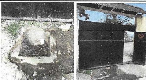
Foto 9: REJILLA METALICA - PORTON (Se realizara rejilla metalica de 0.60x0.60 en el área de ingreso para cubrir registro de drenaje pluvial, se utilizara angular de 1 1/2" x 1/8 - Elevar portón 25 cm para fundicion.)
