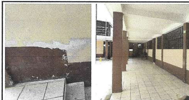
Foto 10: PINTURA. (Pintura general en áreas de salones, servicios sanitarios y muro perimetral, Se aplicara 750 m2 de pintura a dos capas, por deterioro de pintura, se aplicara resanes en las partes necesarias.)
