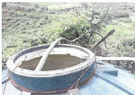
Foto 5: Tinaco en mal estado.
