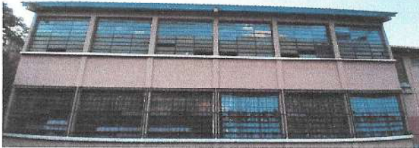
Foto1: Se deben sustituir 10 marcos de metal por marcos de PVC, en el segundo nivel, debido al óxido, las ventanas de vidrio se están despegando
