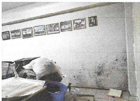
Foto 1 : Reparacion/sustitucion de repello de paredes deterioradas por humedad y hongo, se aplicara material nuevo como barrera antihumedad en 6 salones con un area de 24.00m2 por salón, con un total de 144.00m2
