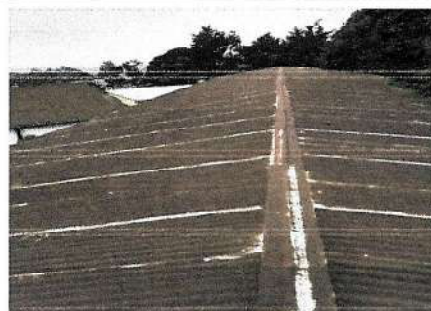
Foto 4: Estado actual de la lamina del techo del establecimiento.
