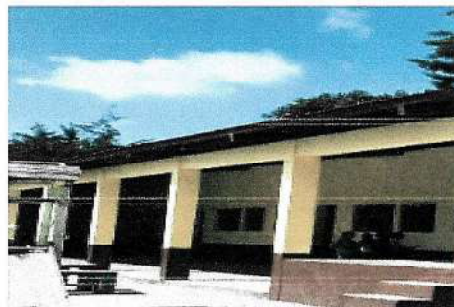
Foto 2: Area de techo que no tiene canal
