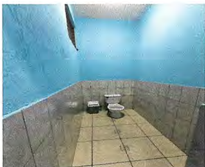
Foto 3: SERVICIOS SANITARIOS Y ACCESORIOS.
